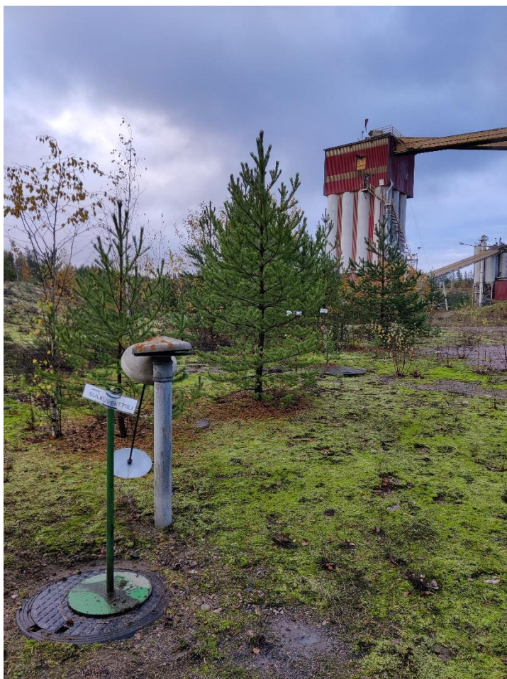
Kuva 2. Hulevesijärjestelmän näytteenottokaivo, kuva 10/2023.
