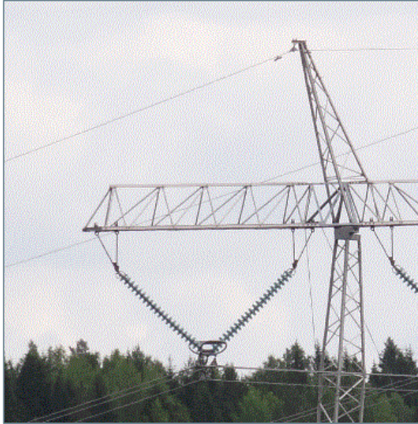
Kuva 6-8. Voimajohtopylvään eristimiä, joissa koronapurkauksia voi esiintyä.
