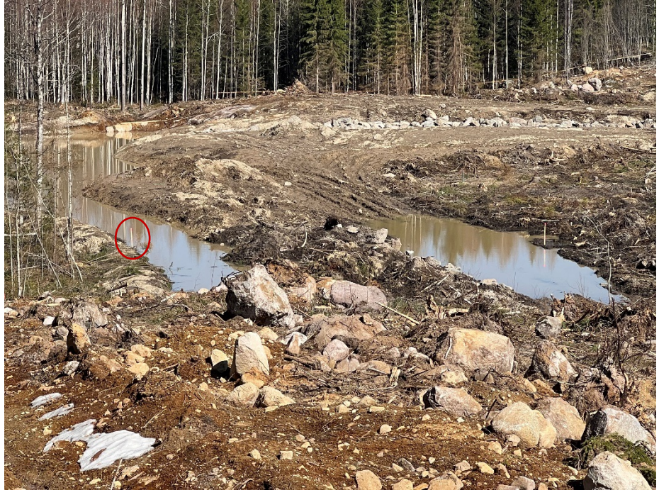
Kuva 1. Kuvassa ympyröitynä olevaan merkkiin ojan reunalla on merkattu luo-alueen rajan sijainti. Raja kulkee todellisuudessa 2 metriä oikealle, joten oja on tässä kohtaa osittain luo-alueella. Oikealla sulamisvesistä muodostunut lammikko varsinaisen laskeutusaltaan ulkopuolella.
