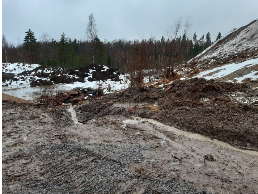
Kuva 4. Valumavedet ohjautuvat tien ali ojaan, josta ne virtaavat kunnostettuun vesienkäsittelyaltaaseen.
