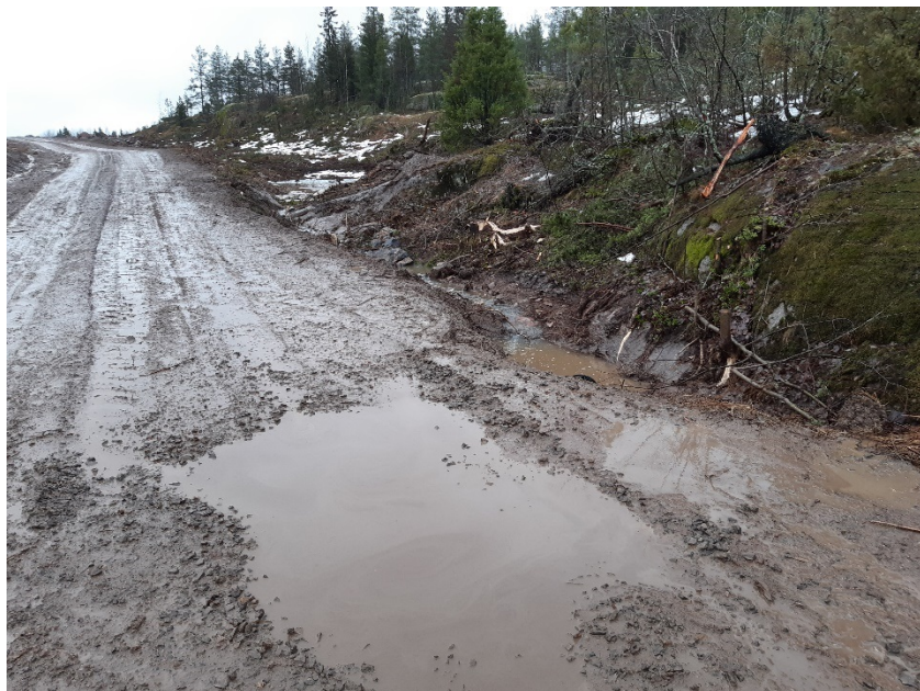
Kuva 3. Maanvastaanottoaikan laelle johtavan tien itäpuolelta oli ohjattu valumavedet uutta tien ali kulkevaa rumpua pitkin maanvastaanottoaikan eteläreunalla kulkevaan ojaan.
