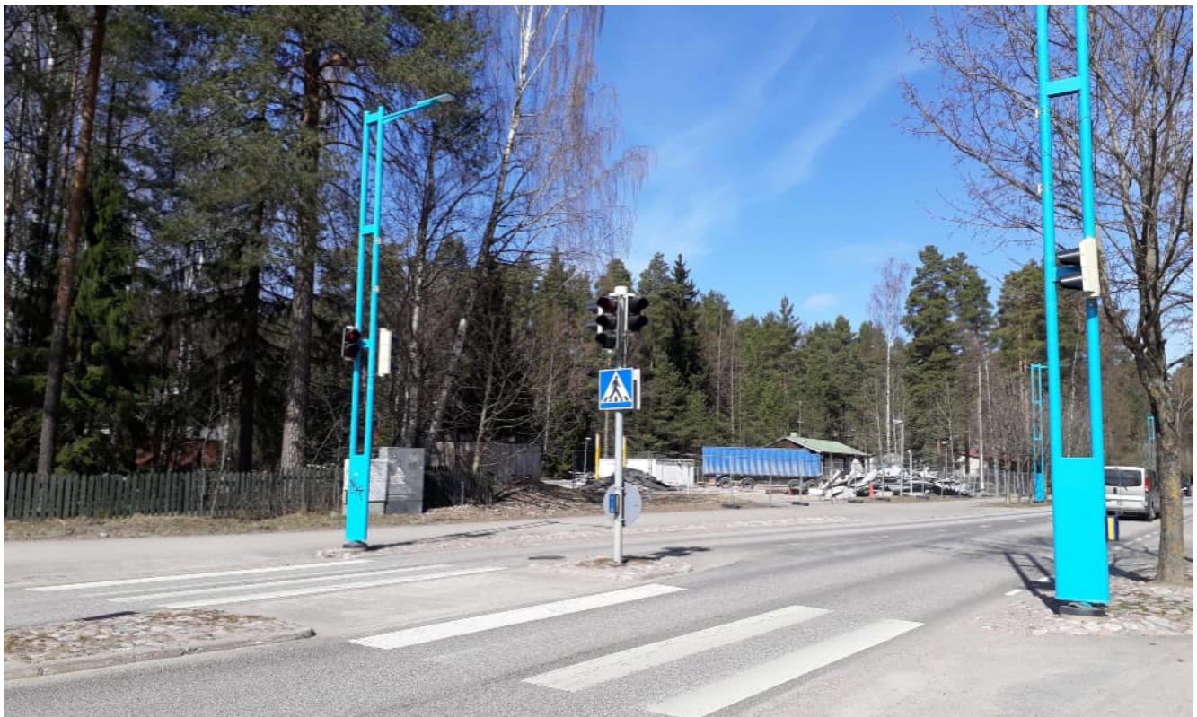
Kuva kaavamuutosalueesta Vihdintien ja Lohjantien risteyksestä otettuna. Kuva on otettu huhtikuussa 2021. Nesteen huoltoaseman purkutööt ovat käynnissä. © Vihdin kunta.
