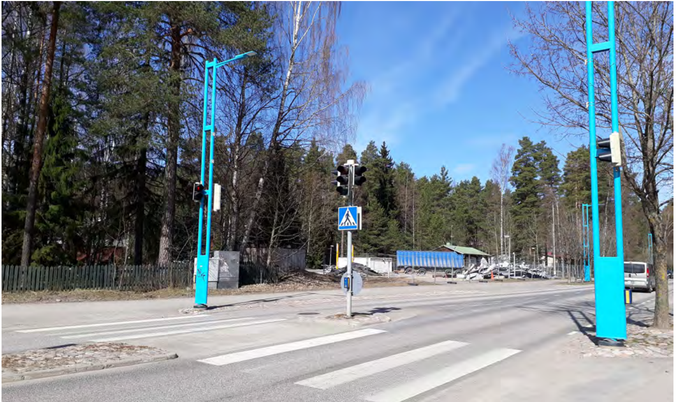
Kuva kaavamutosalueesta Vihdintien ja Lohjantien risteyksestä otettuna. Kuva on otettu huhtikuussa 2021. Nesteen huoltoaseman purkutyöt ovat käynnissä. © Vihdin kunta.
